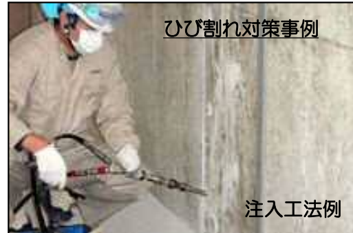
【コンクリートの損傷対策】
